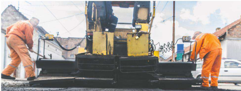
Différents projets de réfection de rue sont prévus au cours des prochains mois.
